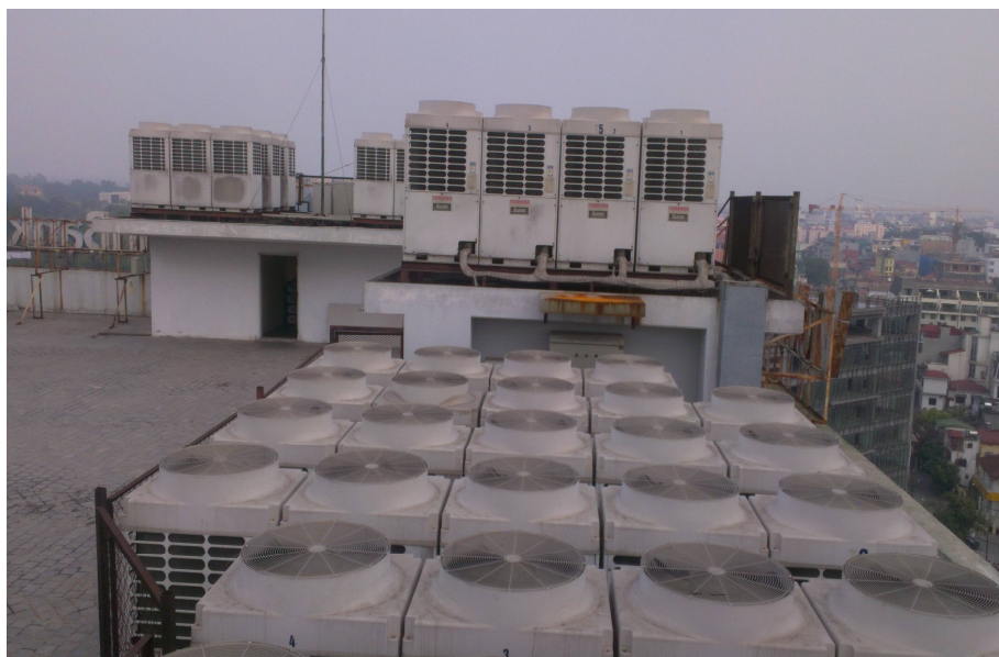
Công trình: Bảo trì, sửa chữa hệ thống Điều hòa trung tâm VRF- Toshiba tại Ngân hàng TMCP công thương Việt Nam số 34 – Cửa Nam – Hà Nội
